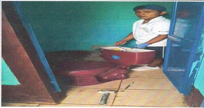
Servicios sanitarios y accesorios
