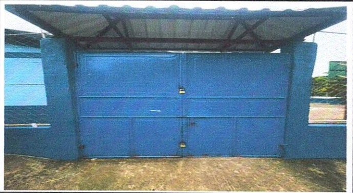
Puerta de portón
