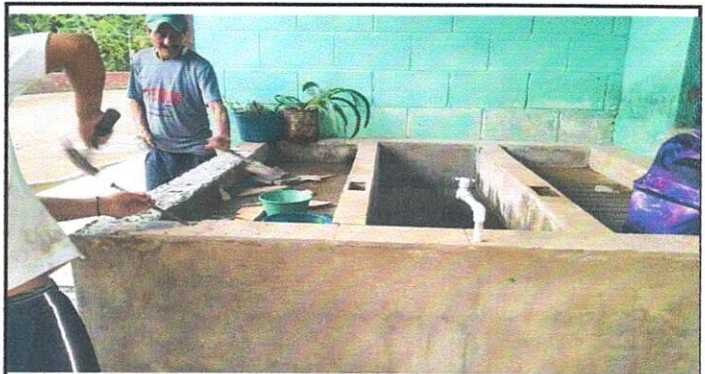
Sustitución de pila y azulejo: pila de cocina y pila de patio
